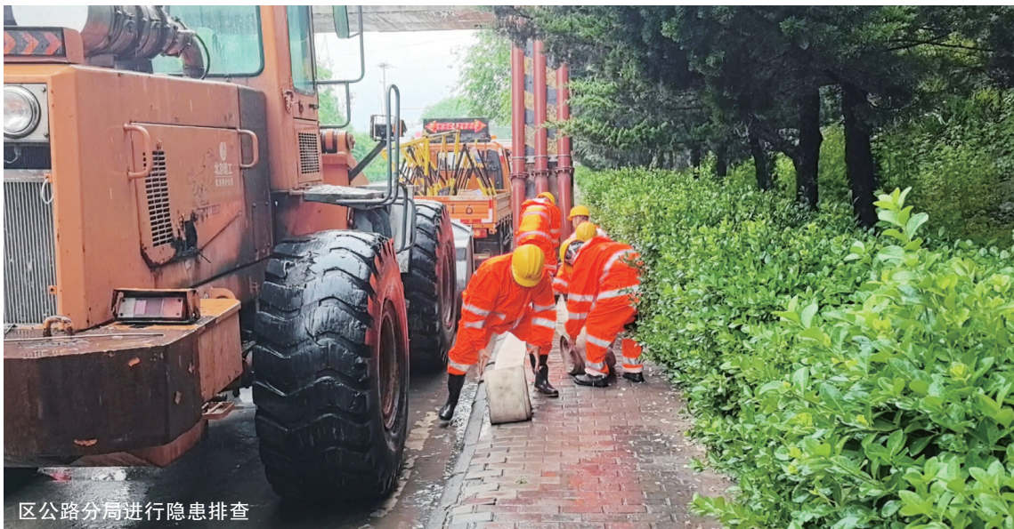
区公路分局进行隐患排查
